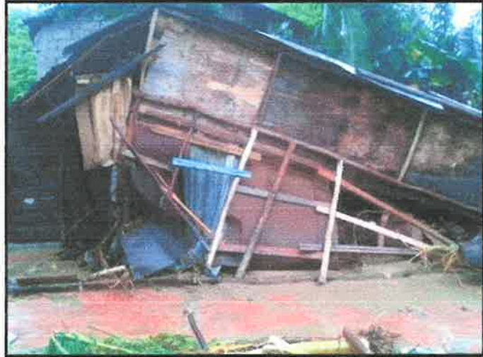
Foto 4.4.1.1.3-2. Casa destruida por las inundaciones
