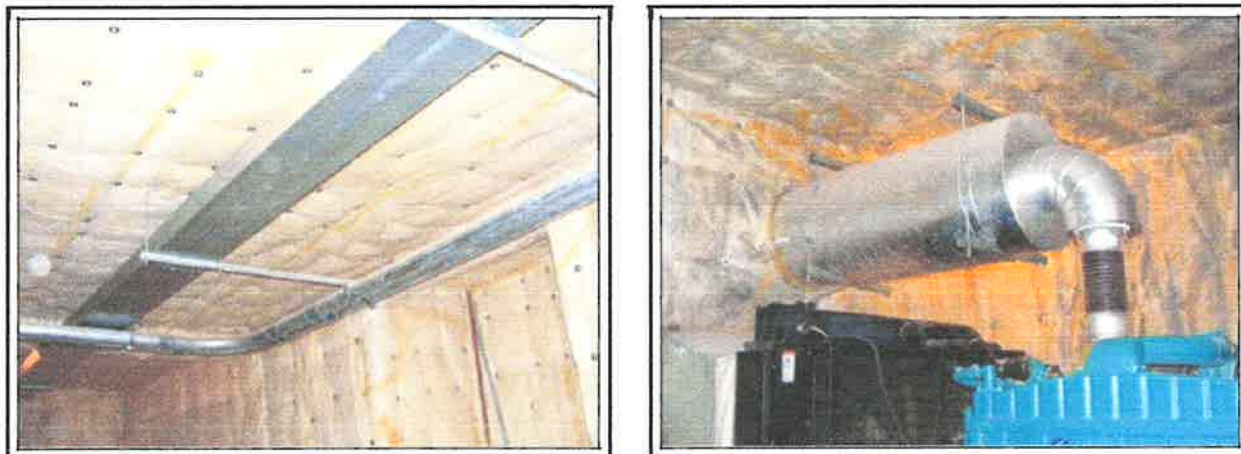
Fotos 4.4.4-1. Ejemplo de los elementos aislantes en paredes y techo de cuarto de un generador eléctrico.
