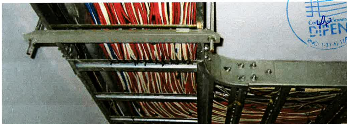
Distribución usando cables THHN en escalerillas.
