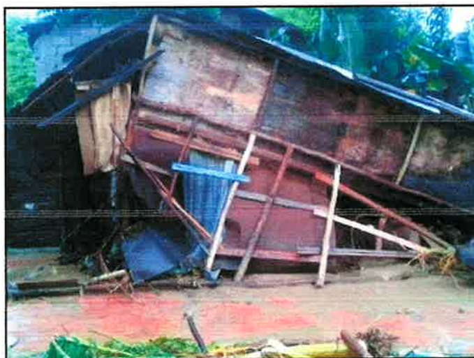
Foto 3.2.1.1.3-2. Casa destruida por las inundaciones
